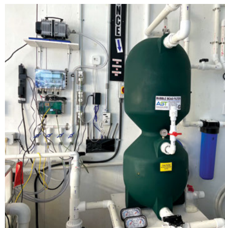
Les appareils nécessaires à la purification de l'eau. Photo : Marie-Hélène Paradis / JDV
