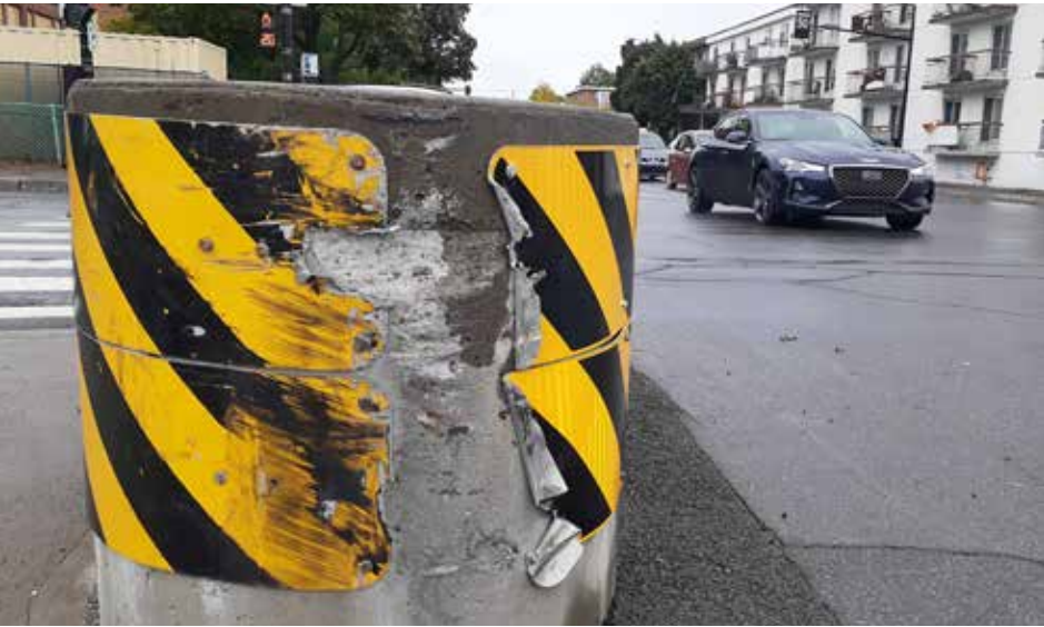
Des voitures ont heurté un muret de béton, au coin des boulevards Henri-Bourassa et Saint-Laurent. (Photo : Philippe Rachiele, JDV)
