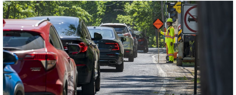
La circulation à une seule voie entre l'avenue Martin et le boulevard Toupin occasionne de la congestion automobile. (Photo : François Robert-Durand, JDV)
