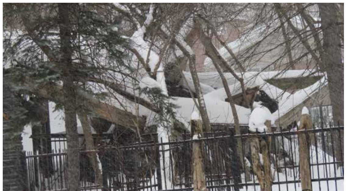
À l'arrière, on aperçoit qu'une partie du toits'est effondrée à la suite d'un incendie survenu il y a plusieurs années. (Photo : Philippe Rachiele, JDV)
