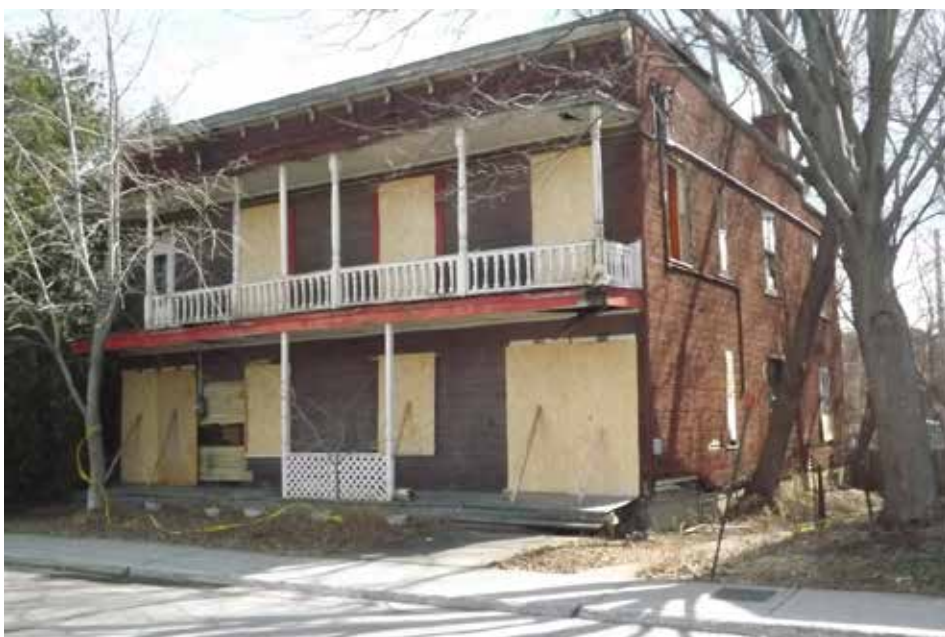
La maison du peintre, située au 2124, boulevard Gouin Est, était tellement détériorée que Le bâtiment original a été démolie. (Photo : Philippe Rachiele, archives JDV)
